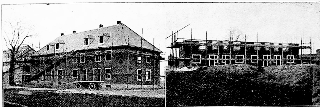
Im „Freiborf“ in Muttensz bei Basel. Bild rechts. Stand der Arbeiten an dem am meisten vorgeschrittenen Häuserblock am 21. Februar 1920. Bild links der gleiche Block (von der Vorderseite) am 15. März. — Am Tage des Redaktionsschlusses, am 21. März, war auf 13 Blöcken mit 56 Häusern der Dachstuhl aufgerichtet, 8 weitere Blöcke mit 18 Häusern waren bis unter den Dachstuhl aufgemauert.
